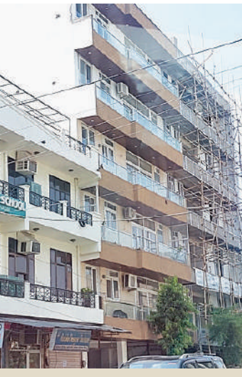
582 A अवैध निर्माण बनकर खड़ा हो गया और अब उससे सटकर 574 का अवैध निर्माण है अंतिम चरण पर। नगर निगम मालवीय नगर जोन सोया है मिलीभगत कर नीड में।
