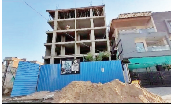
250/4 राजापार्क जवाहर नगर थाने की सड़क के दाईं ओर होता अवैध निर्माण।
