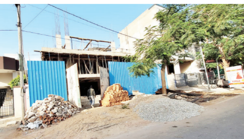
270/4 राजापार्क, जवाहर नगर थाने के सामने बायीं ओर होता निगम की परमिशन के विपरीत अवैध निर्माण। निस-देह अनुमति का बोर्ड लगा है लेकिन कागज़ों की अनुमति और मौके के निर्माण में बड़ा फ़र्क आसानी से देखा व समझा जा सकता है।
