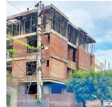
प्लॉट न. C-20 सेक्टर 22, प्रतापनगर JDA के प्रवर्तन अधिकारियों को ये अवैध निर्माण नज़र क्यों नहीं आते?
